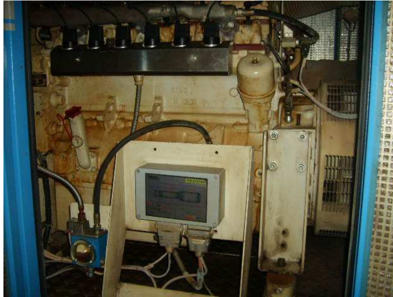
Obr. 8 Spalovací motor kogenerační jednotky Tedom
