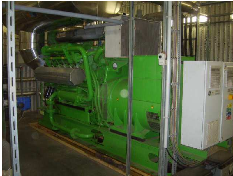
Obr. 4 Kogenerační jednotka GE Jenbacher
